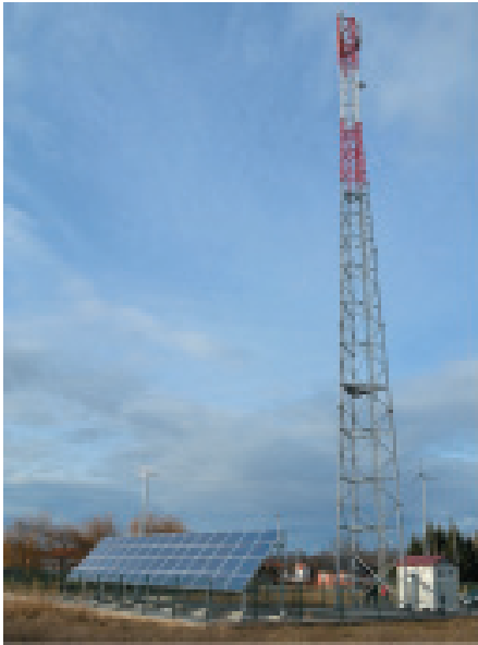
Slika 7 Hibridni sustav bazne stanice u Ladimirevcima
